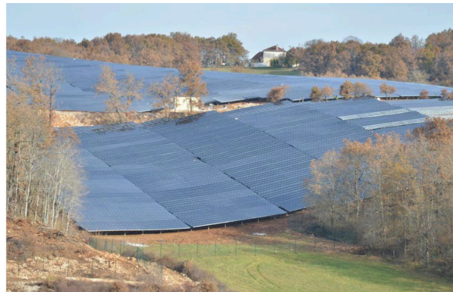
Parc photovoltaïque de Cressensac-Sarrazac. Source DDM
