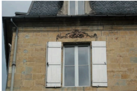
Décor en terre cuite surmontant une fenêtre d'un immeuble en pierre de taille à Saint-Céré
