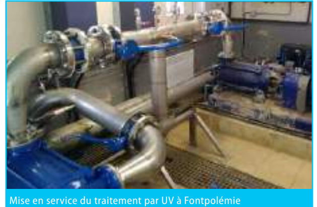
Mise en service du traitement par UV à Fontpolémie
