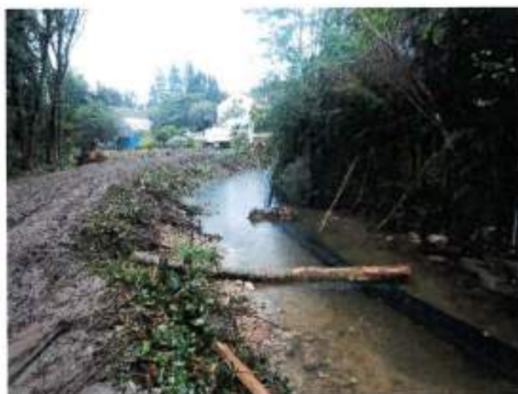
Travaux sur la Borrèze à Souillac (retalutage des berges, restauration d'une zone d'expansion de crue, plantation d'espèces adaptées au bord de rivière)
